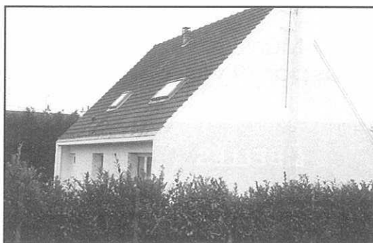
Le ravalement extérieur a été refait entièrement et la huisserie P.V.C. de l'étage.
