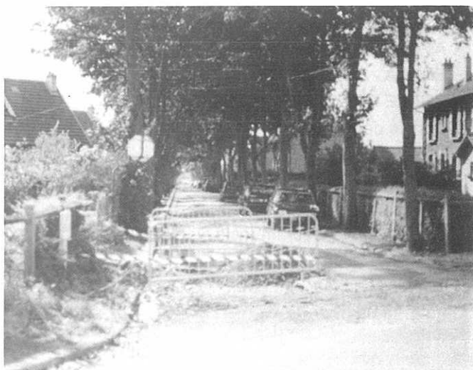
3 ème phase de travaux plateau (rue des Bleuets, Marguerites, Coquelicots et Clos neuf)
