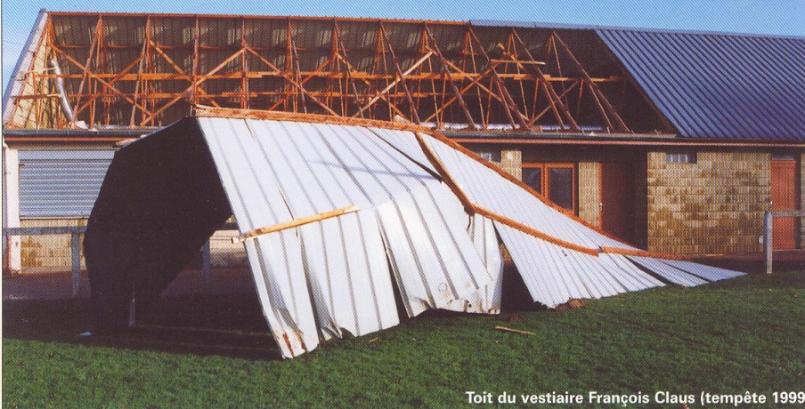
Toit du vestiaire François Claus (tempête 1999)
